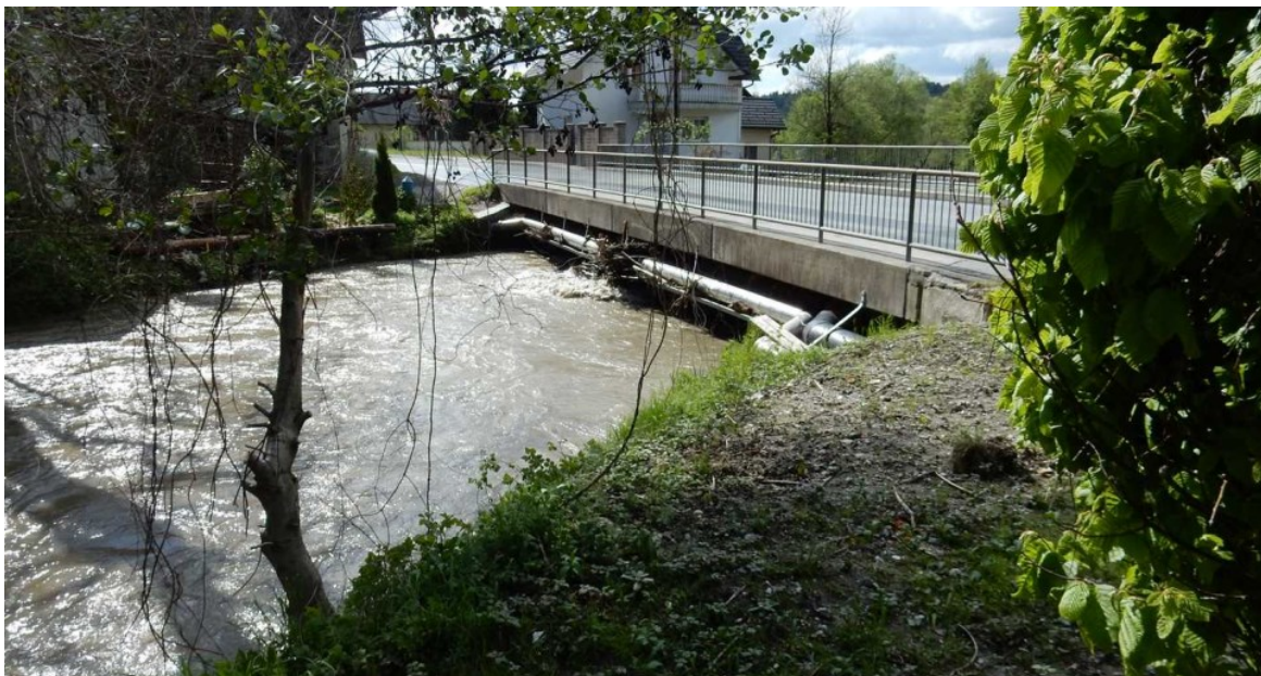
Zaradi poplave ogrožena vodovodna cev na mostu v Kamniku (foto: P. Banovec)
