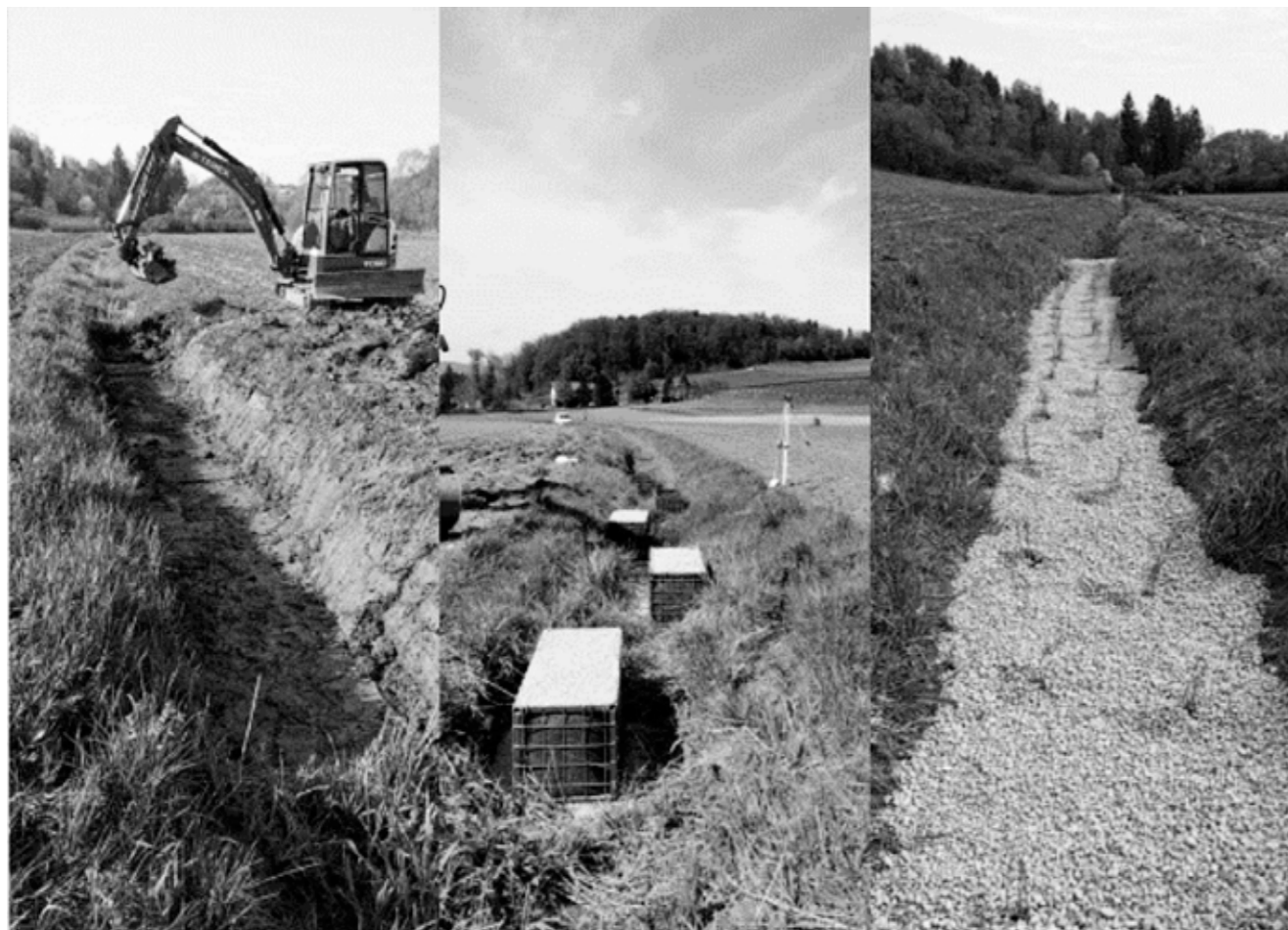
Slika 1: Gradnja grajenega ekosistema; od leve usedalnik, odsek umetnega meandriranja, čistilna greda; Meja Šentjur, Ponikva.
